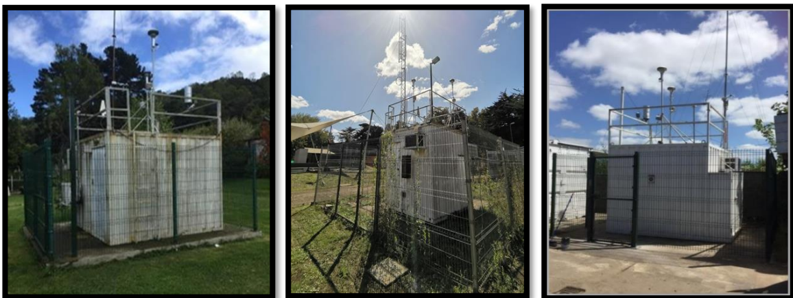
Estaciones de Monitoreo de Calidad de Aire en Temuco y Padre Las Casas. De Izquierda a derecha Estación Ñielol, Las Encinas y Padre Las Casas II
